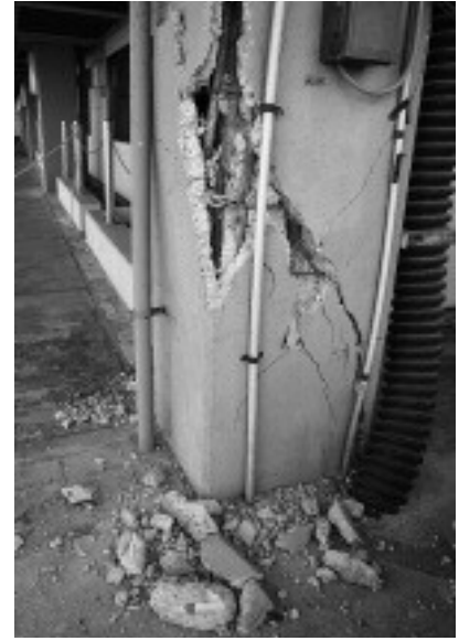
▲地震で損壊した議場棟の柱
